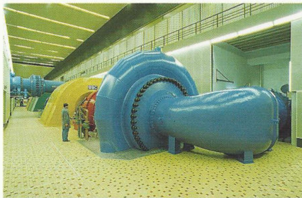
Die Pumpe A7 fördert 21.000 Liter Wasser in der Sekunde über 400 m in das Eggbergbecken.
