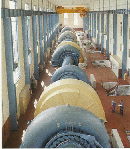
Vier Maschinensätze, bestehend aus Turbine, Generator/Motor und Pumpe
